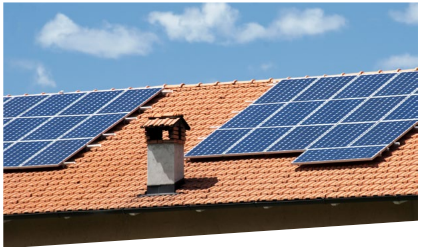
Solceller installeret på tag.
